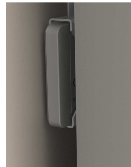
Rangement de la télécommande derrière le radiateur
